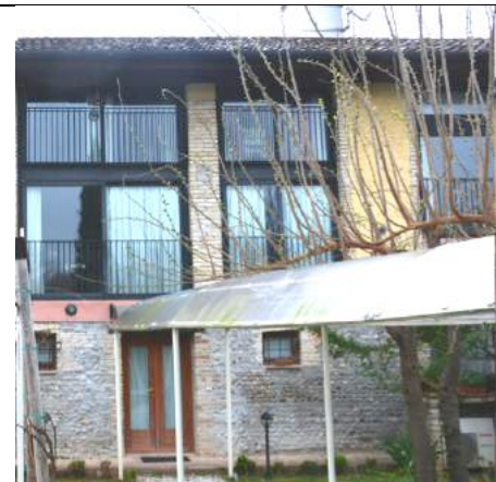
Accettabile mantenimento dei fori (Tettoia non compatibile)
