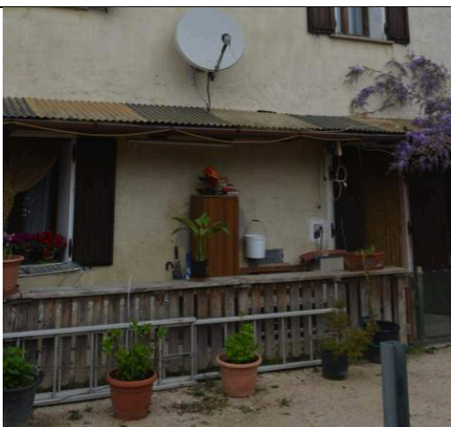
Coperture di protezione provvisorie ed in plastica: non compatibili
