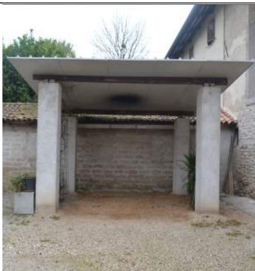
Materiali, dimensioni, copertura non compatibili
