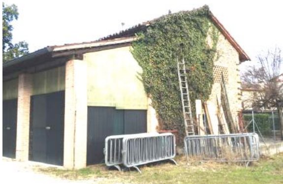
Eccessiva larghezza in ampliamento di corpo di fabbrica esistente
