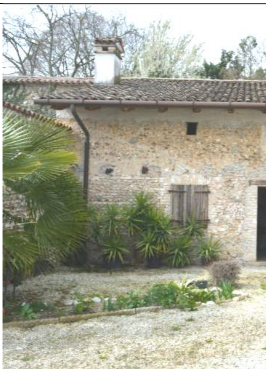
Cordolo sotto la copertura e montanti in calcestruzzo su muro in pietra: attenzione all'effetto percettivo. Procedere con tinteggiature sulla parte nuova in toni del colore delle pietre, unificare la percezione.
